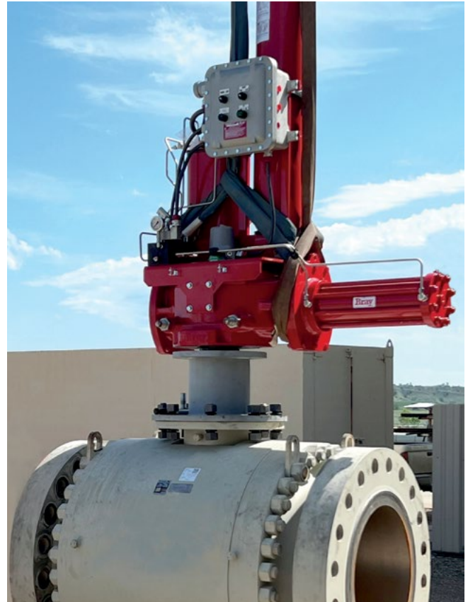
Actuador electrohidráulico de cero emisiones y ensamblaje de trunnion - válvula de bola montada sobre muñón que se está preparando para la puesta en marcha de tuberías.
