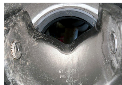
Después de 24 meses en servicio, la inspección del S19L no mostró signos de erosión en la segmento de bola, el asiento, las paredes cuerpo o el revestimiento.
