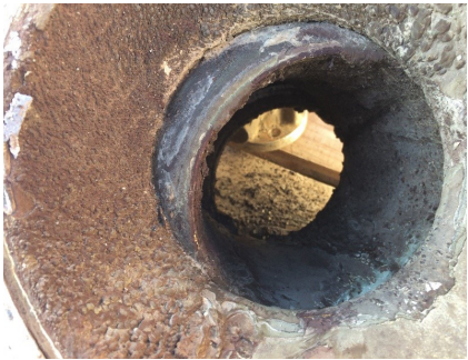
Luego de 2 meses en servicio, la válvula del competidor muestra signos de acumulación de producto severa aguas arriba, lo cual causa fugas frecuentes y depósitos.
