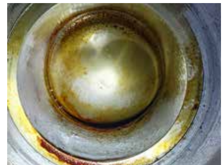
Estas imágenes muestran señales mínimas de abrasión en el segmento de bola después de 90 días (superior) y 180 días (inferior). Después de cada inspección, la válvula volvió a ponerse en servicio.
