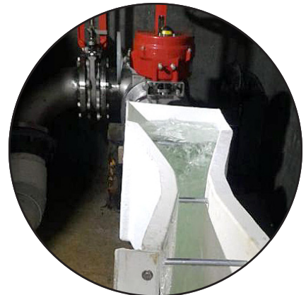
Medidor de vazão calha Parshall usado para medir a vazão das águas na superfície.
