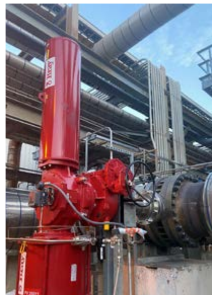
Válvula borboleta triexcêntrica Tri Lok instalada com atuador pneumático de jugo escocês da Série 98 e posicionador digital. Os dois conjuntos de válvulas aumentaram muito a eficiência operacional no processo de desidrogenação de propano.
