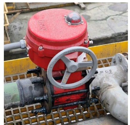
Válvulas revestidas Série 39L com atuador Série 70 proporcionaram maior precisão de controle com maior vida útil operacional.
