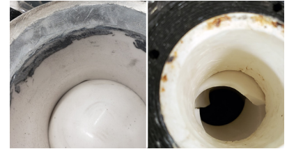
Wskutek działania agresywnego medium (z lewej) zastosowane wykładziny ceramiczne zaworów kulowych wykazują silną erozję i wycieki, a także uszkodzenia w obrębie połączenia trzpień i kula wskutek zakleszczenia kuli (z prawej).
