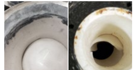
Durch das aggressive Medium (links) wiesen die vorhandenen keramisch ausgekleideten Kugelhähne starke Erosion und Leckagen auf und es kam zu Ausfällen der Wellen und Kugel Verbindung aufgrund von festsitzende Kugeln (rechts).
