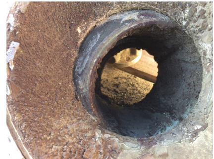
Nach 2 Monaten im Einsatz zeigte das Ventil eines Mitbewerbers Anzeichen für eine starke Anreicherung von Medien im Vorlauf, was zu häufigen Leckagen und Blockierungen führte.
