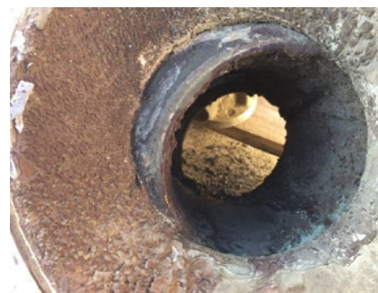
Après 2 mois d'utilisation, cette vanne concurrente présentait des accumulations importantes de dépôts, provoquant des fuites majeures et des blocages.
