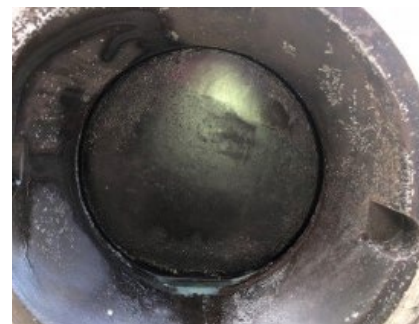
Après 18 mois d'utilisation sans problème, la vanne ne présentait pas de signe d'usure ni d'accumulation de dépôt en amont.
