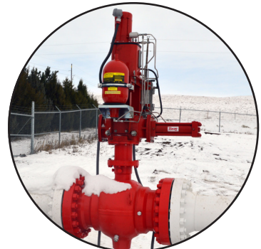
博雷的98EH系列双作用执行机构内置蓄能器，安装于天然气输送球阀上。
