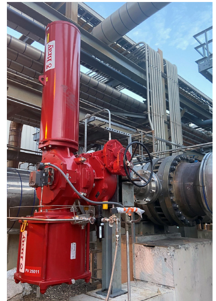
与 98 系列拨叉式气动执行机构和数字定位器一起安装的 Tri Lok 三偏心蝶阀。两套阀门已显著提升了丙烷脱氢工艺的操作效率。
