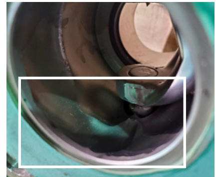
对竞争对手的故障控制阀进行检查后发现,阀体壁和法兰区域显示出大范围的侵蚀迹象。
